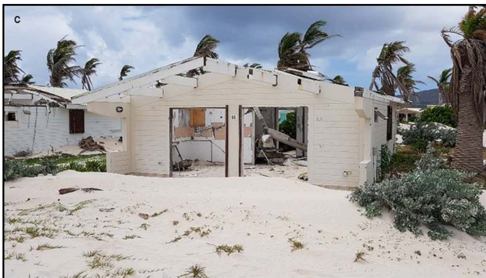
Illustration 7c - Matériaux transportés par les vagues cycloniques : ensablement des rez-de-chaussée des bâtiments situés sur le front de mer
